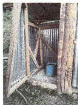
Foto 4: Inodoro de fosa septica instaladas.
